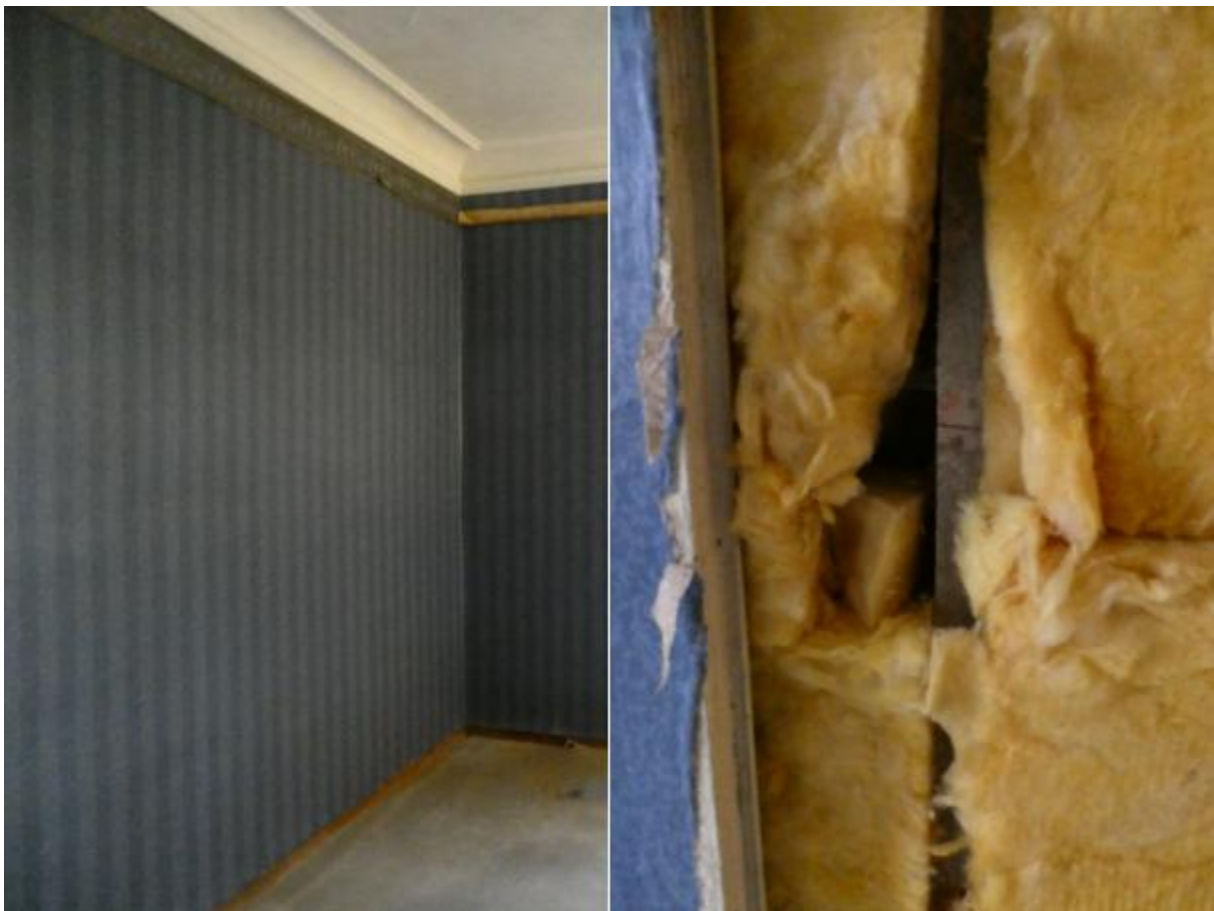
Abbildung 51: Schlafzimmer mit Wandbeschädigungen
