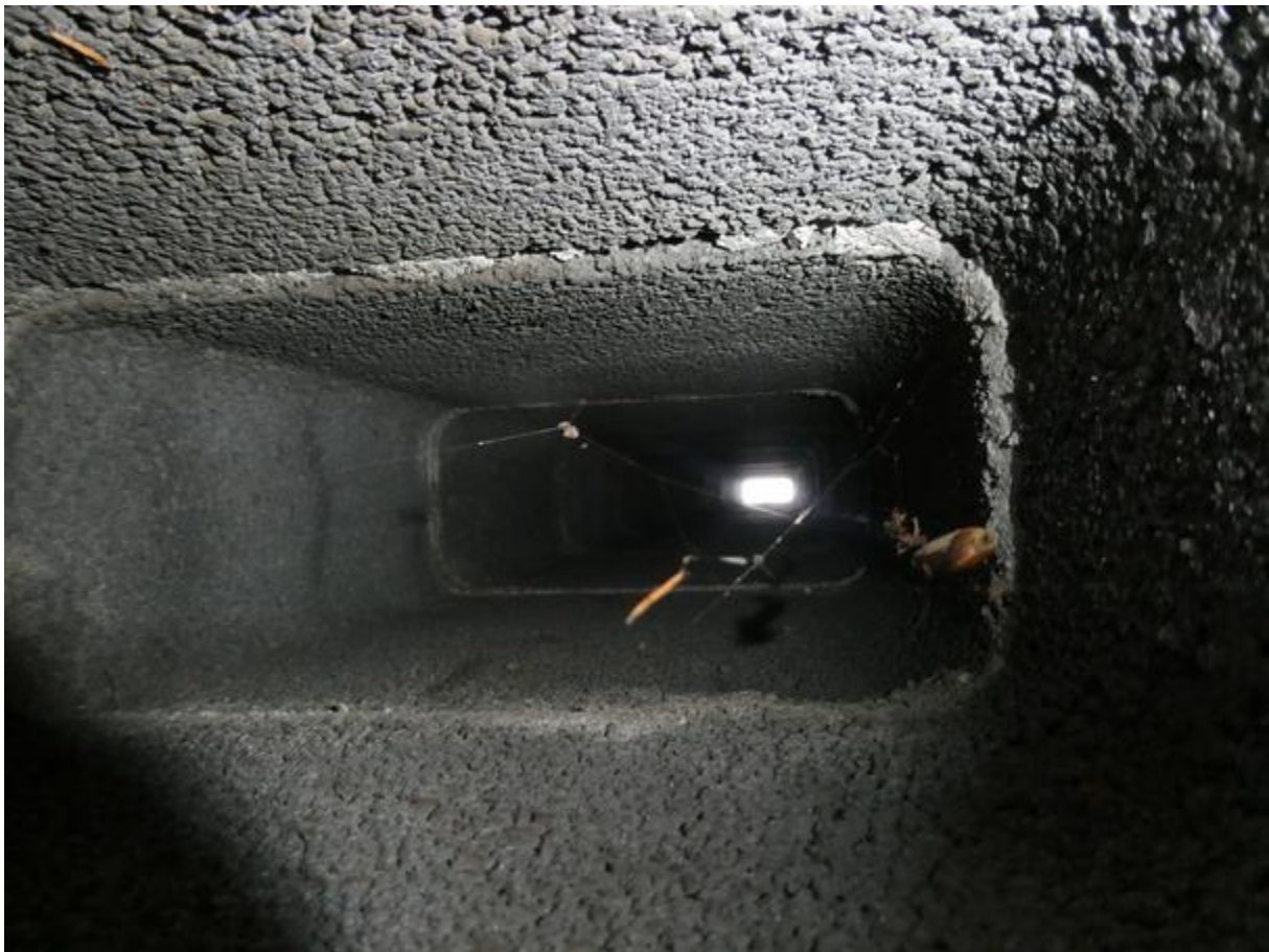
Abbildung 61: Kamin; als Einflugmöglichkeit für Fledermäuse nicht geeignet (horizontale Ausrichtung).
