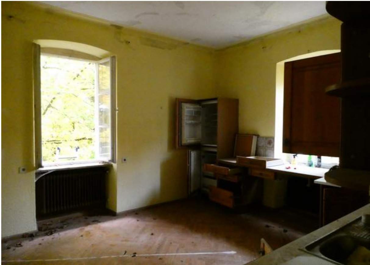
Abbildung 48: Küche; das Fenster ist permanent geöffnet.
