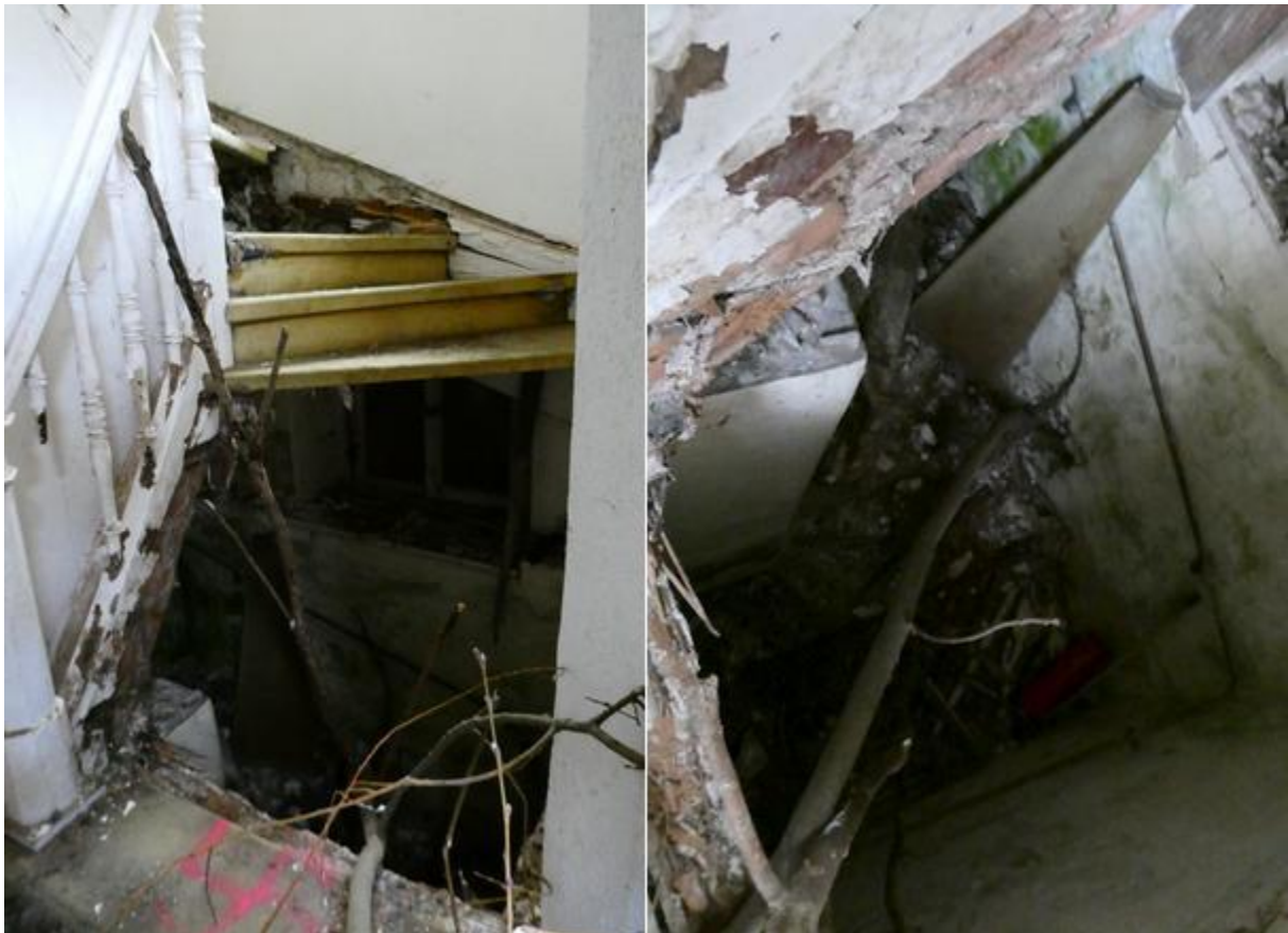
Abbildung 41: Zustand des Treppenhauses (EG zu 1, OG)
