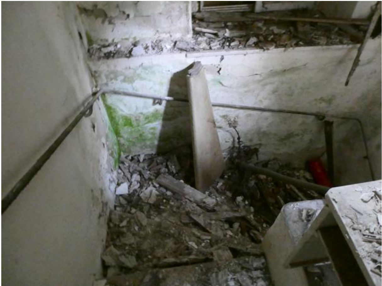
Abbildung 42: Zustand der Treppe zum Kellergeschoss
