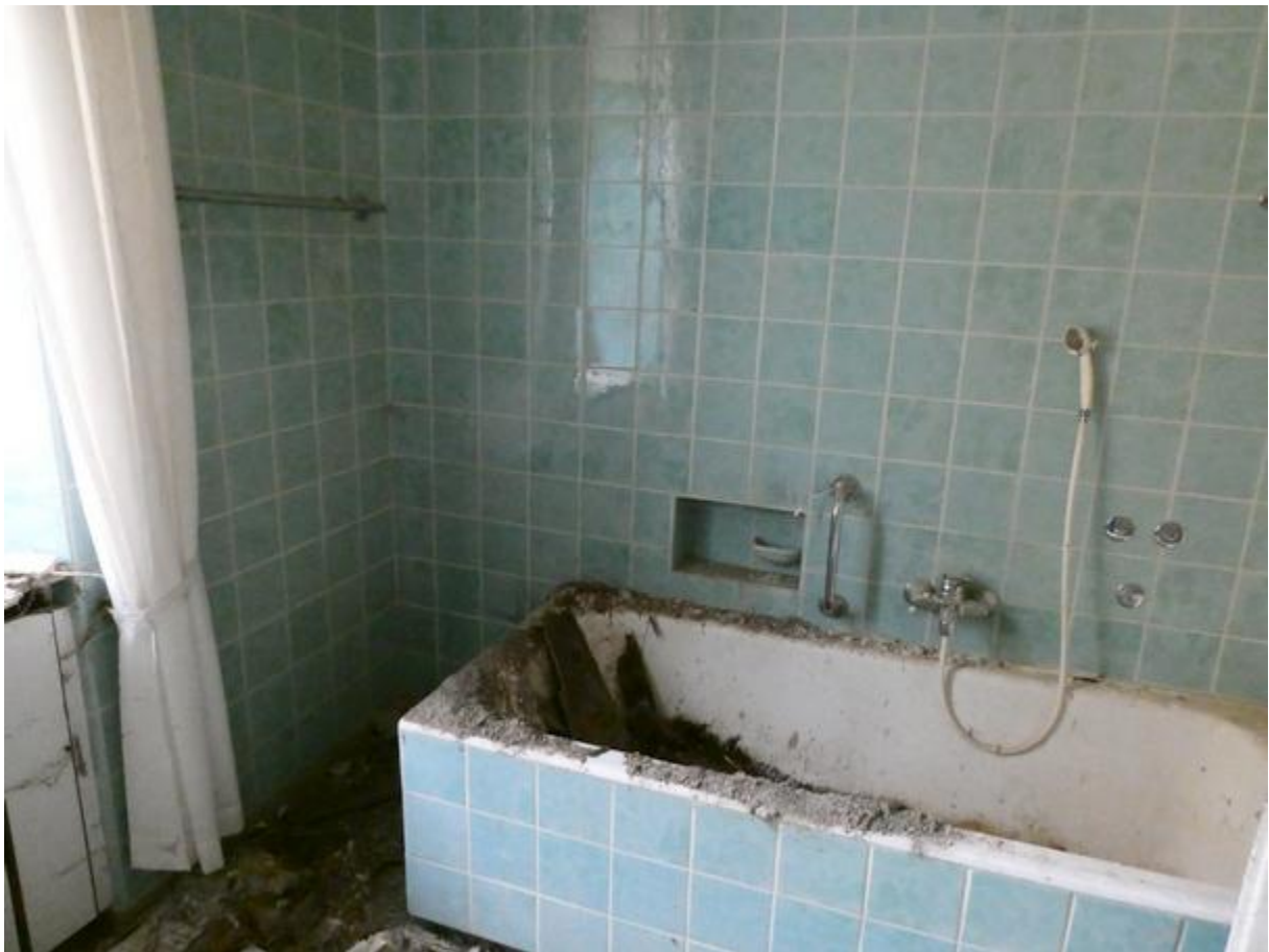
Abbildung 52: Badezimmer mit Deckenschutt
