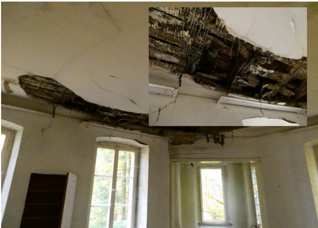
Abbildung 49: Zustand der Decke im Wohnzimmer
