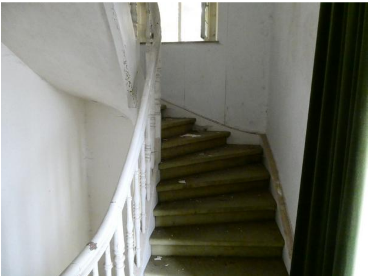
Abbildung 53: Treppe zum 2. OG; Zustand nicht abschätzbar.
